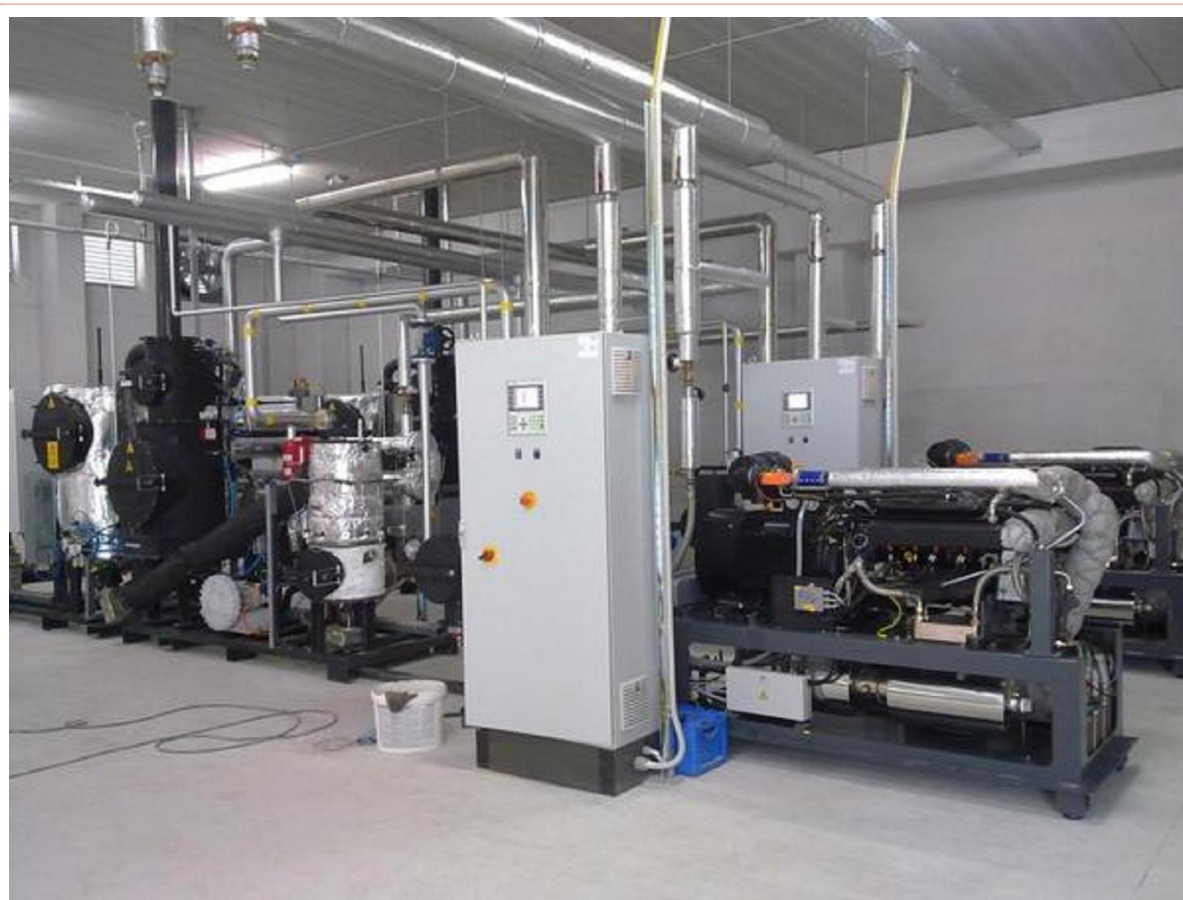
Postrojenje elektrarne na lesno biomaso podjetja EVJ Elektroprom
